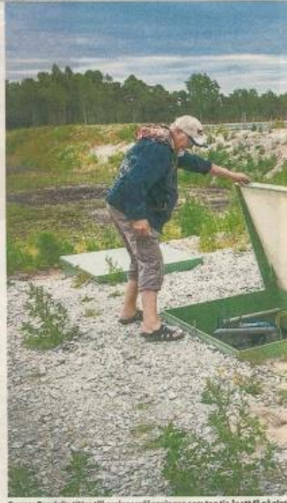
Gunnar Bendelin tittar till reningssanläggningen som tog tio år att få på plats.
